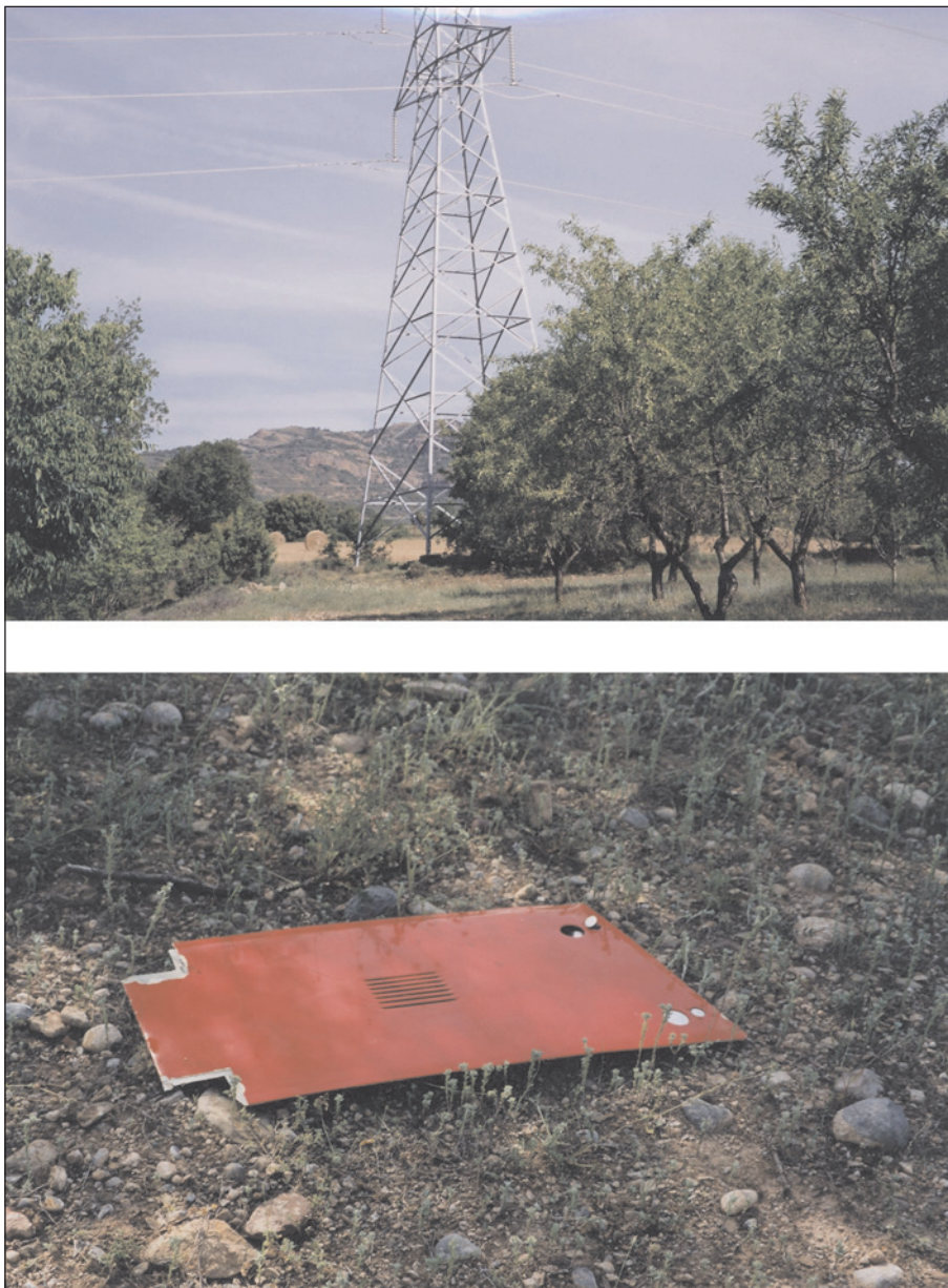
Figura 1.12.3. Tapa del registro y apoyo n.º 13 de la línea eléctrica
