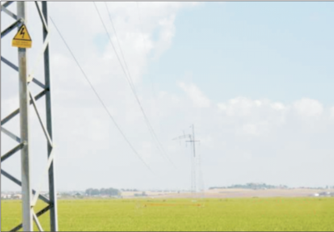
Vistas de los apoyos partidos de la línea eléctrica
