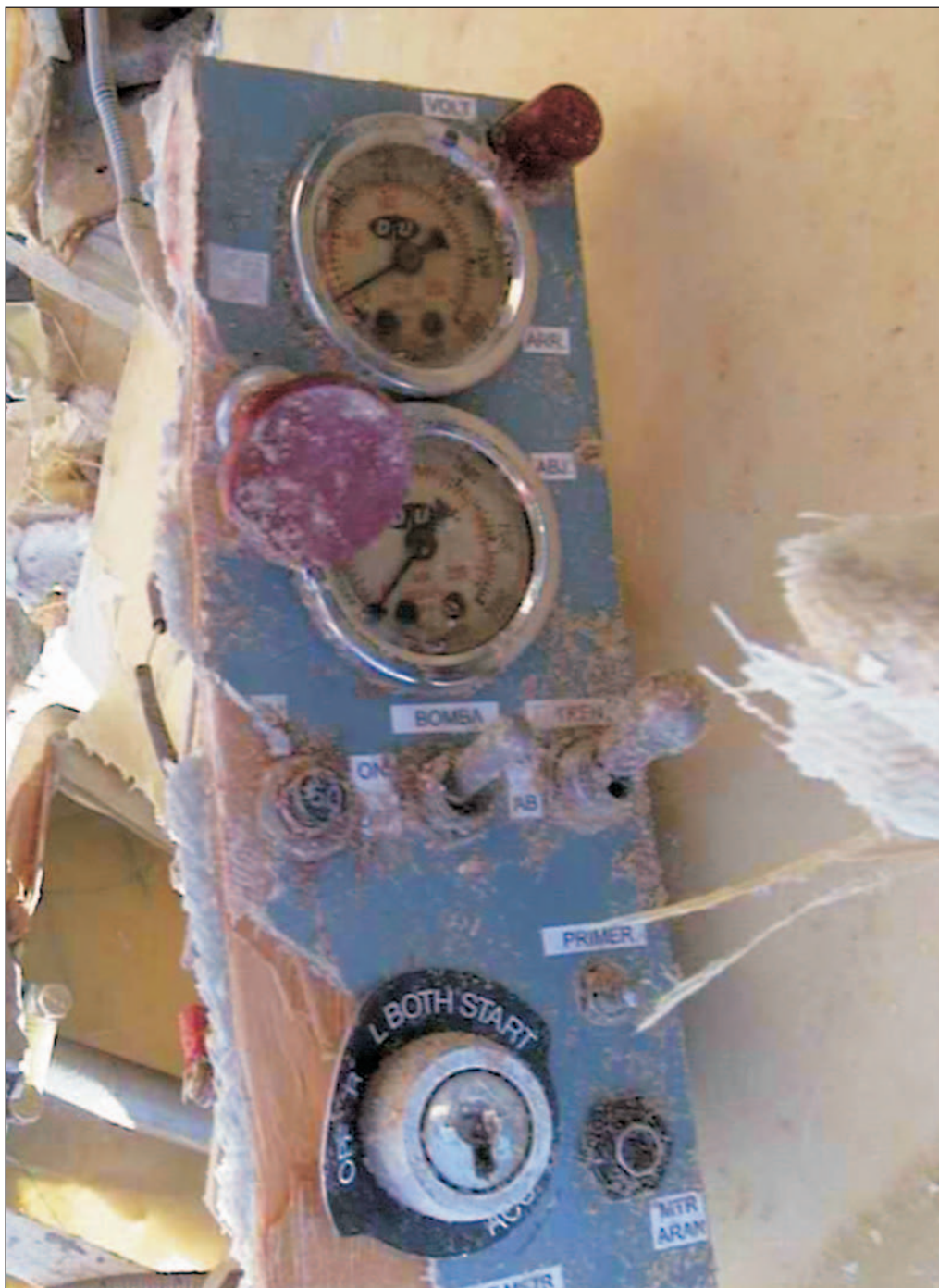
Foto 1.6.4.6. Tras el accidente, los interruptores aparecían como tren arriba y bomba en «ON», con el fusible de 50 A metido. La posición normal del interruptor de la bomba debería haber sido «OFF», una vez que el tren había subido tras el despegue. La posición de la puesta en marcha es «BOTH»
