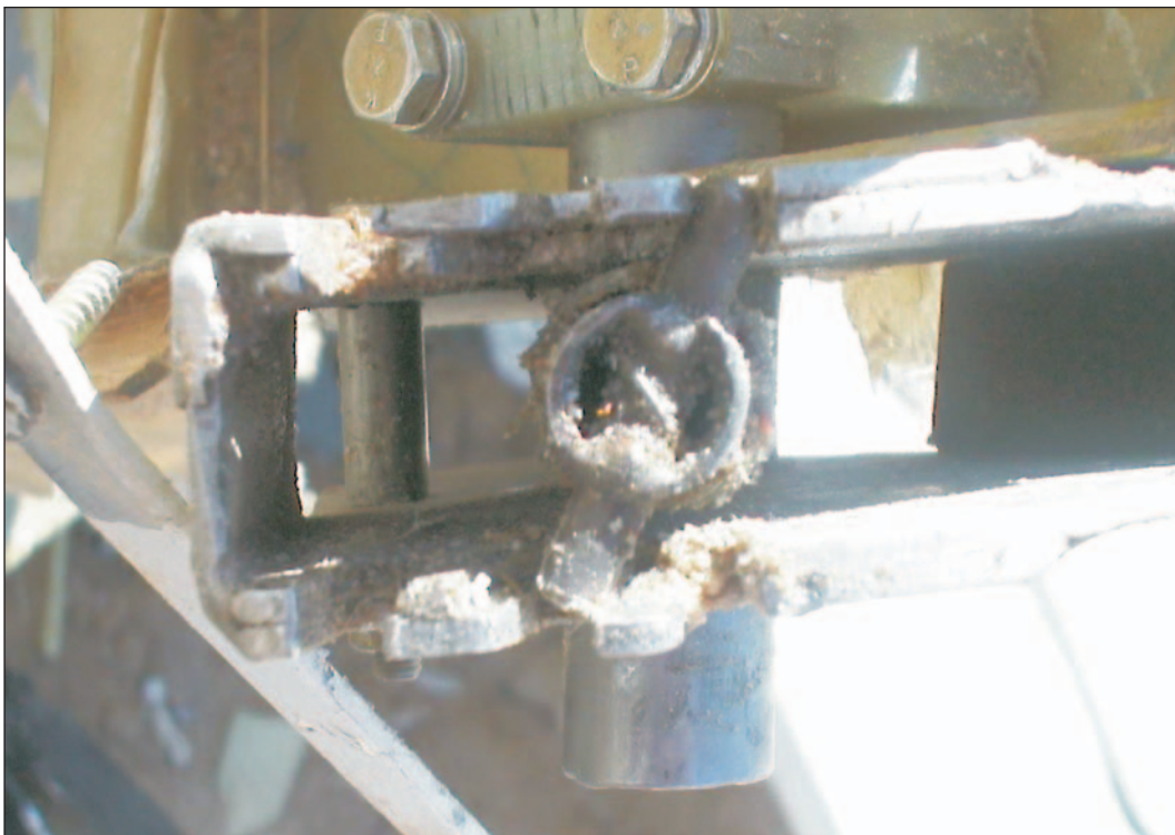
Foto 1.12.2. Posición del mando de flaps tal como se encontró en el lugar del accidente
