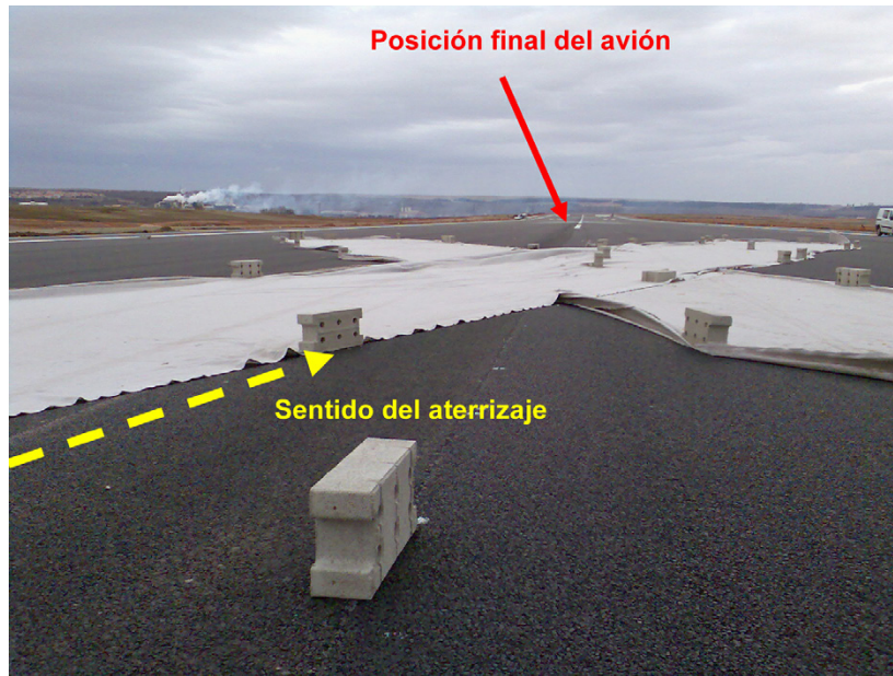
Figura 1. Fotografía de la señalización contra la que golpeó la aeronave
