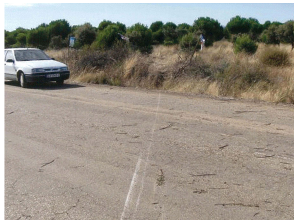
Figura 4. Marcas en la carretera
