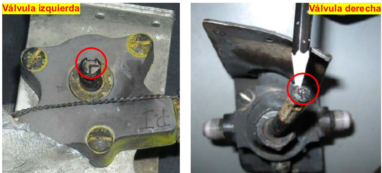
Figura 13. Fotografías de las válvulas vistas desde atrás
