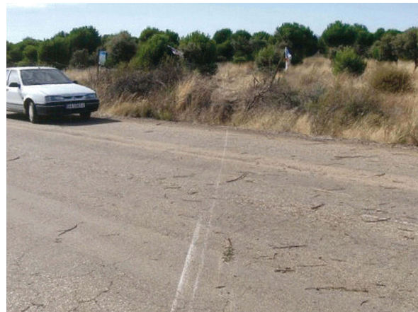
Figura 4. Marcas en la carretera
