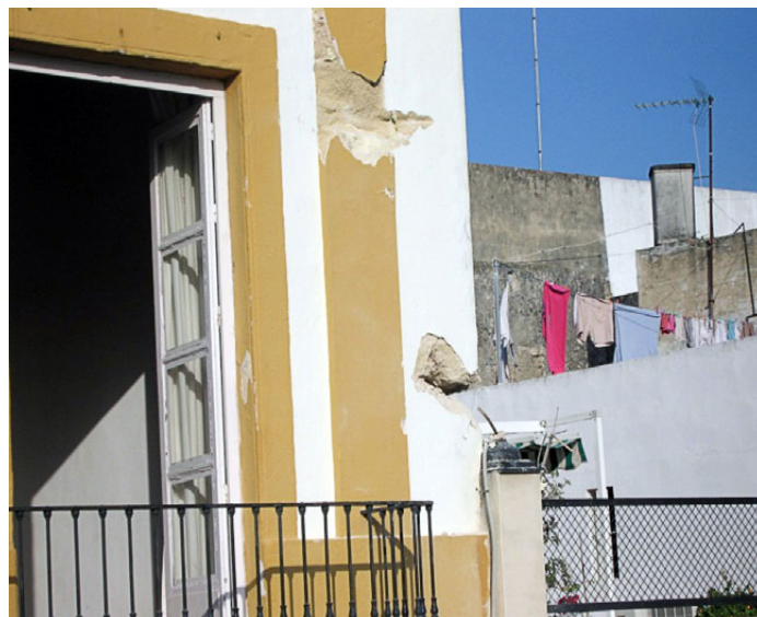
Figura 4. Marcas en fachadas de edificio
