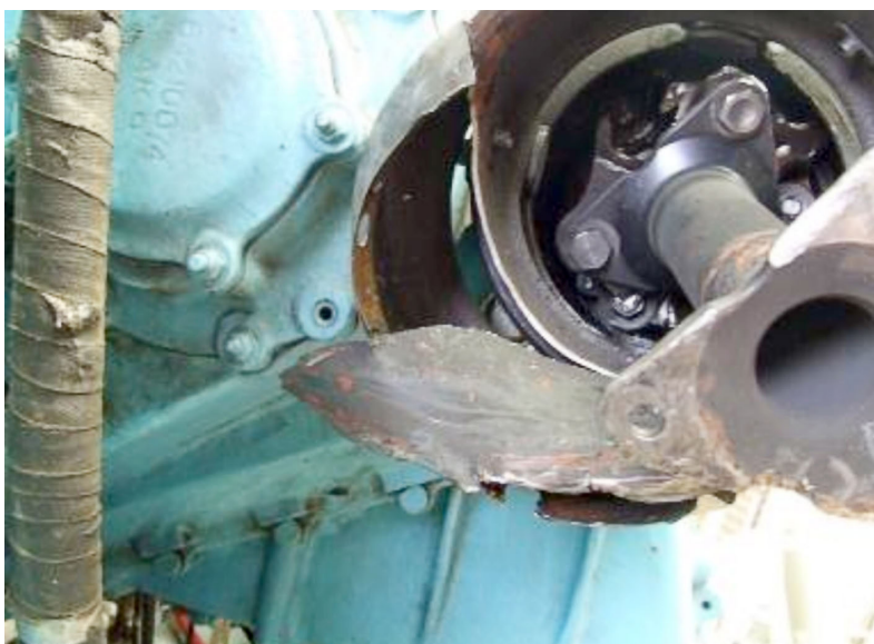
Figura 11. Mismo conjunto visto desde otro ángulo. Se puede apreciar el acoplamiento flexible parcialmente roto entre el eje intermedio con el que entra en la caja combinada
