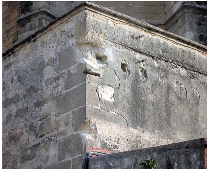
Figura 3. Marcas en fachadas de edificio
