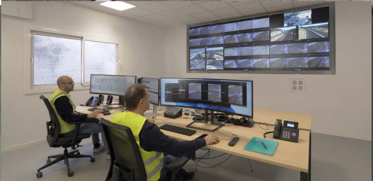
Salida de emergencia y pantallas del centro de control del túnel (debajo).
