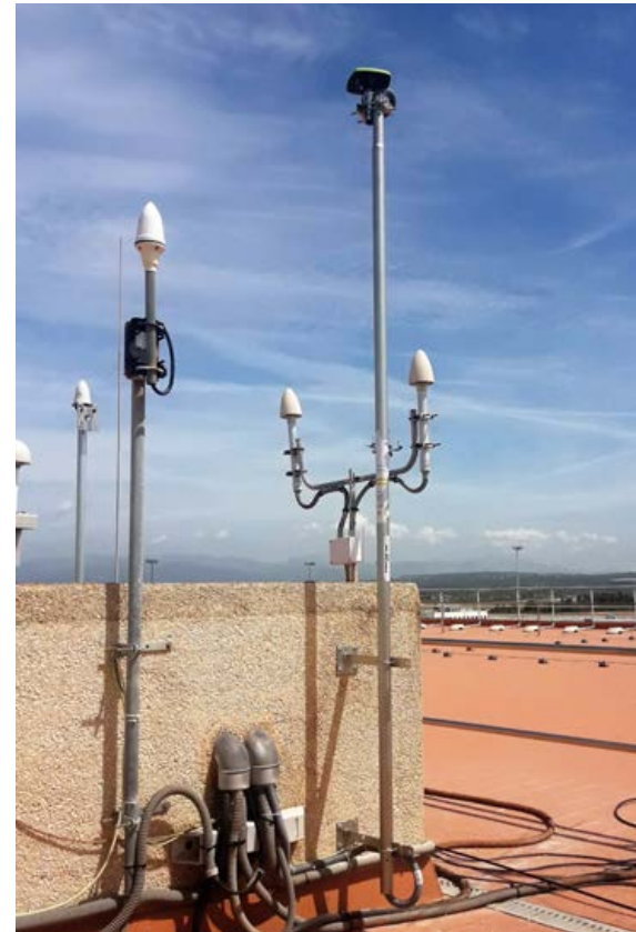
Antena GNSS de estación RECNET de ENAIRE.
