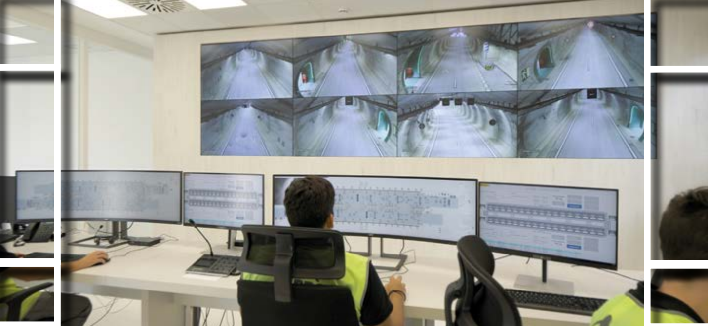
Centro de control del túnel.
