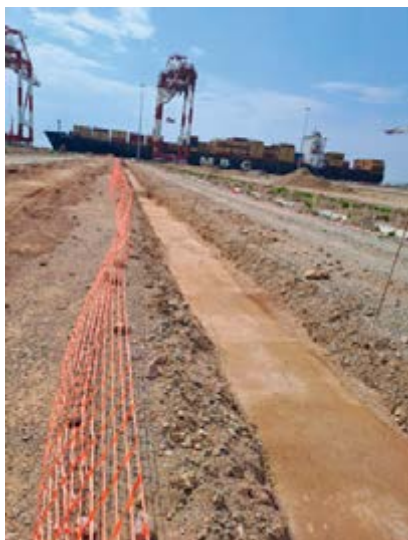
Tomas eléctricas para buques portacontenedores en el Port de Barcelona.
