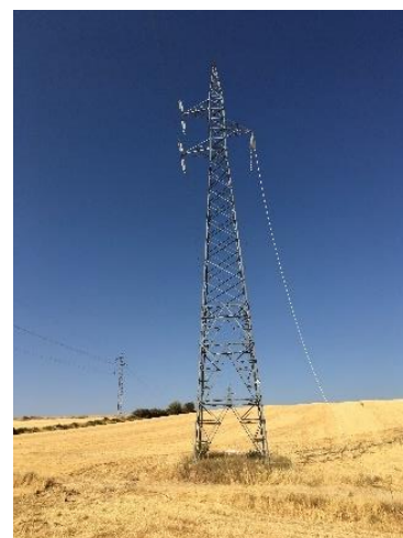
Fotografía 16. Torre y cable seccionado del suceso
