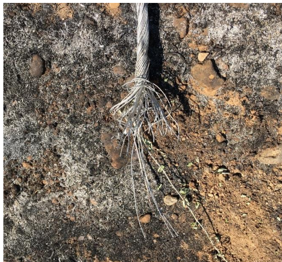
Fotografía 18. Extremo del tendido seccionado de la ladera sur
