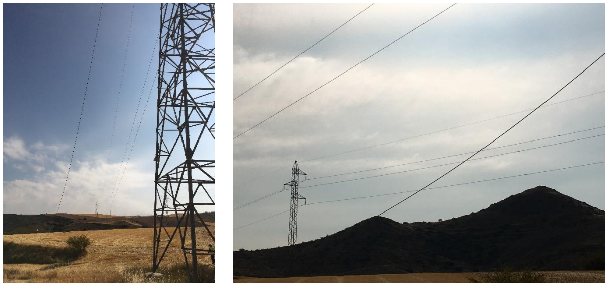
Fotografías 21. Torre y tendidos del lugar del suceso, con cable seccionado por el impacto
