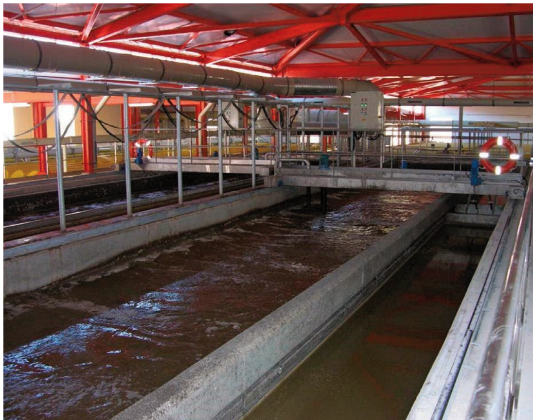
► Tanques de experimentación.
