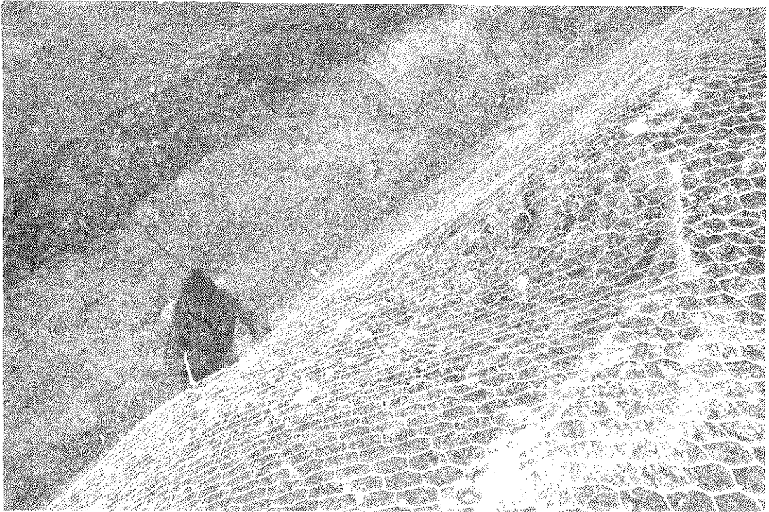
Figura 2.20. — Mallas de protección contra desprendimientos (cortesía de A. Bianchini, Ingeniero, S. A.).
