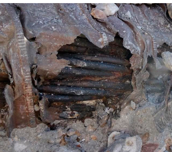
Corrosión del pretensado
