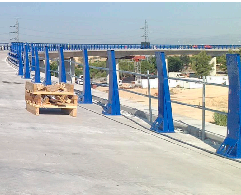
Sistemas de contención de vehículos
