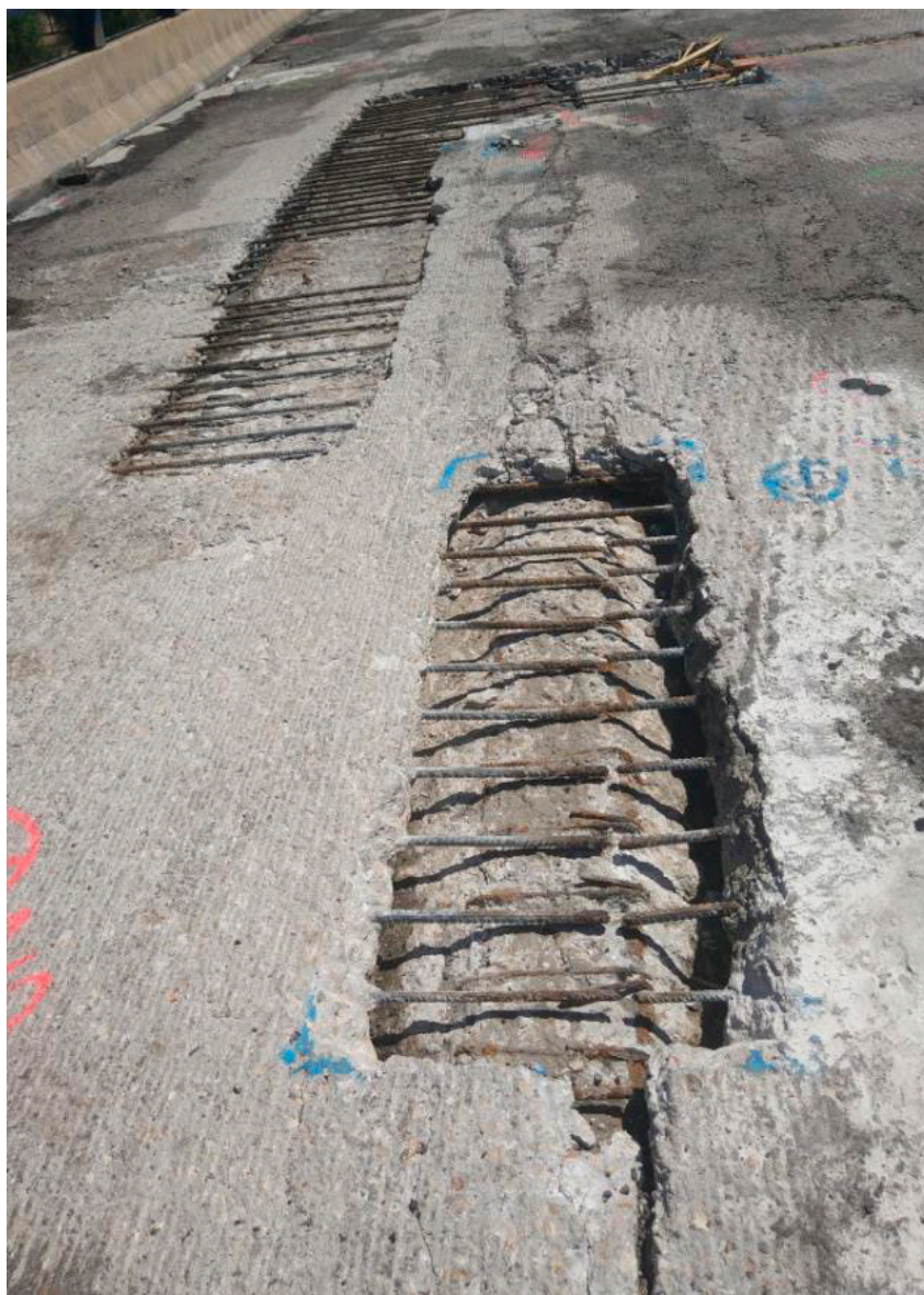
Rotura de armaduras
