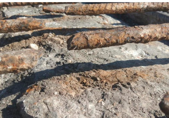
Rotura de armaduras
