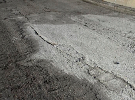
Fisuración en la cara superior del tablero
