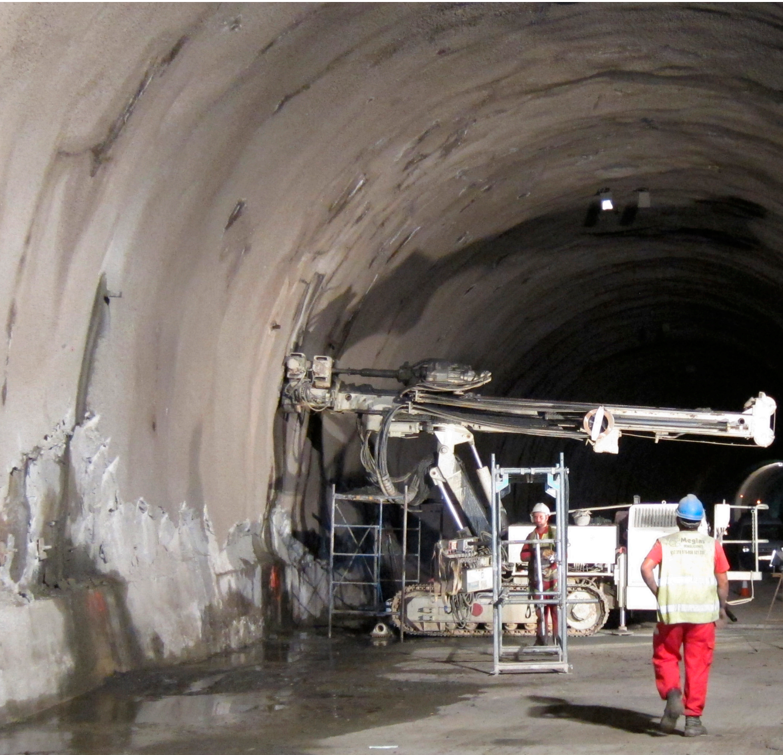
Vista de la deformación observada en el Túnel de Ramoncillos
