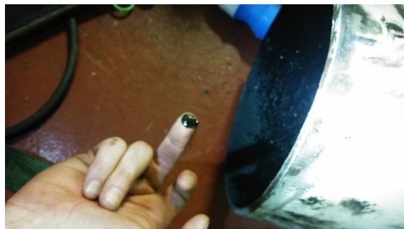
Figura 7. Restos de fueloil en el interior de la tubería de combustible
