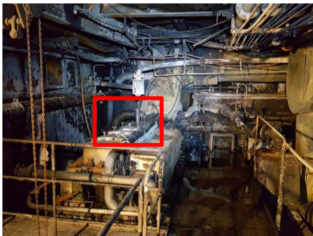
Figura 7. Motor auxiliar en la cubierta 1. Detalle de la ubicación del turbocompresor.
