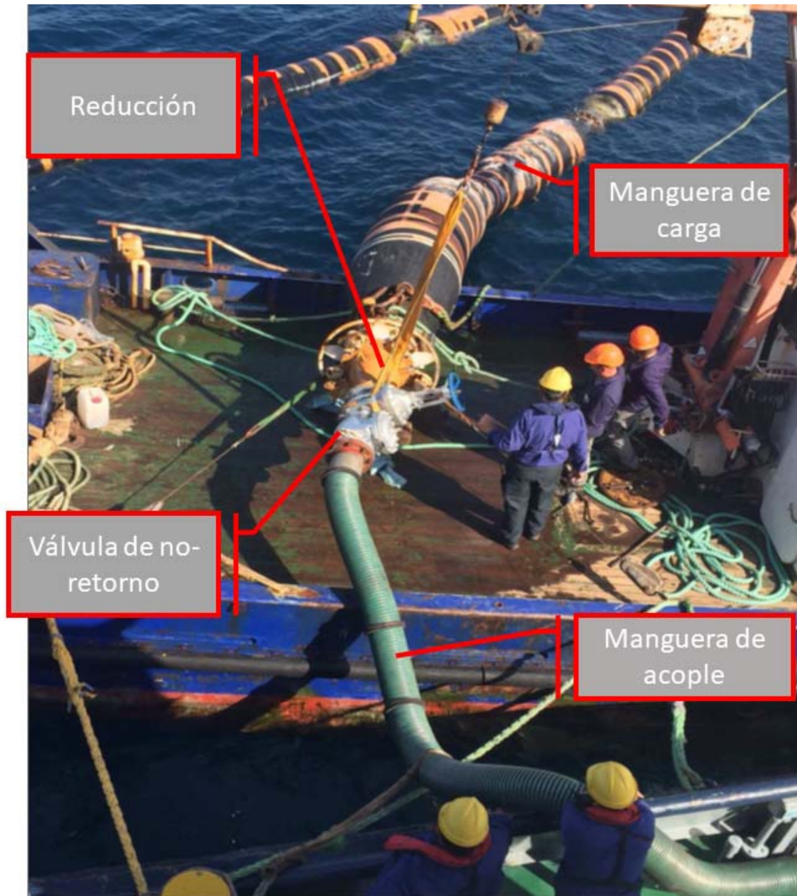
Figura 11. Disposición de los elementos de conexión fuera del remolcador (corresponde a unas operaciones posteriores a las que ocasionaron el derrame de crudo)
