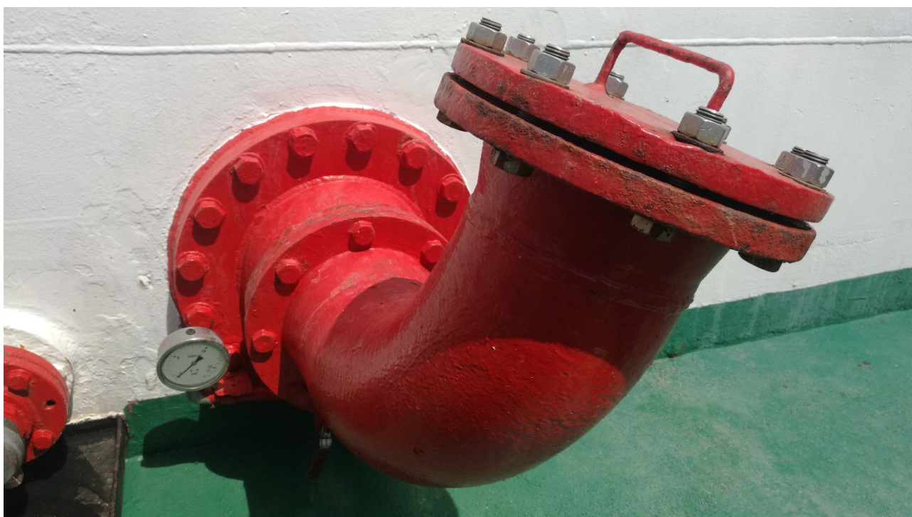
Figura 7. Vista del colector de conexión al sistema FIFI del remolcador
