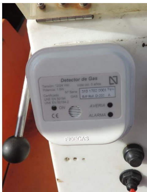
Figura 8. Alarma del sistema de detección de gases dentro de la cámara de máquinas
