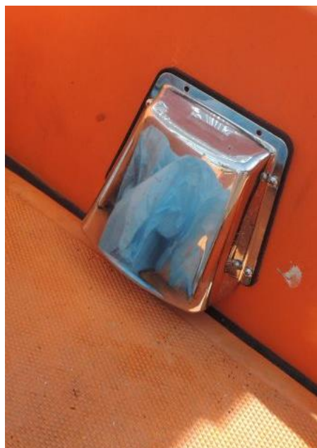
Figura 7. Ventilación del sistema de extracción de gases
