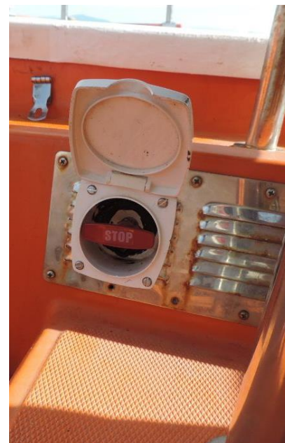
Figura 9. Tirador de activación del sistema de extinción de incendios
