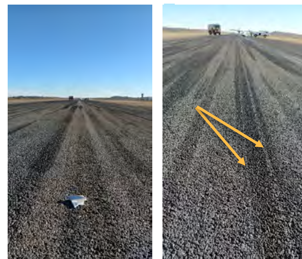
Fotografía 11: Restos de pintura en la pista
