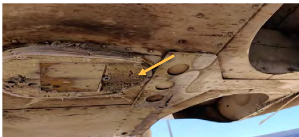
Fotografía 8: Desprendimiento de baliza
