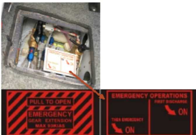
Fotografía 24. Panel de emergencia para extensión de tren
