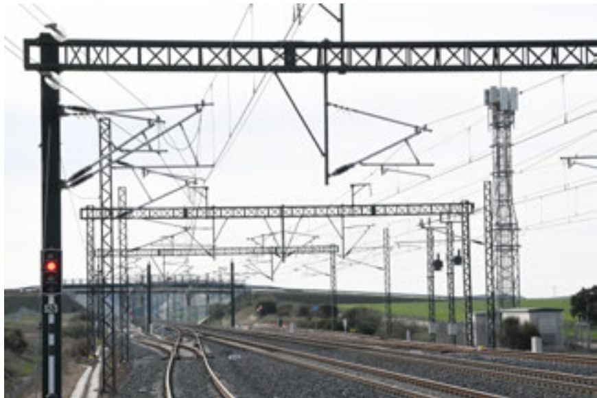
Instalaciones de telecomunicaciones en Valdemoro.
