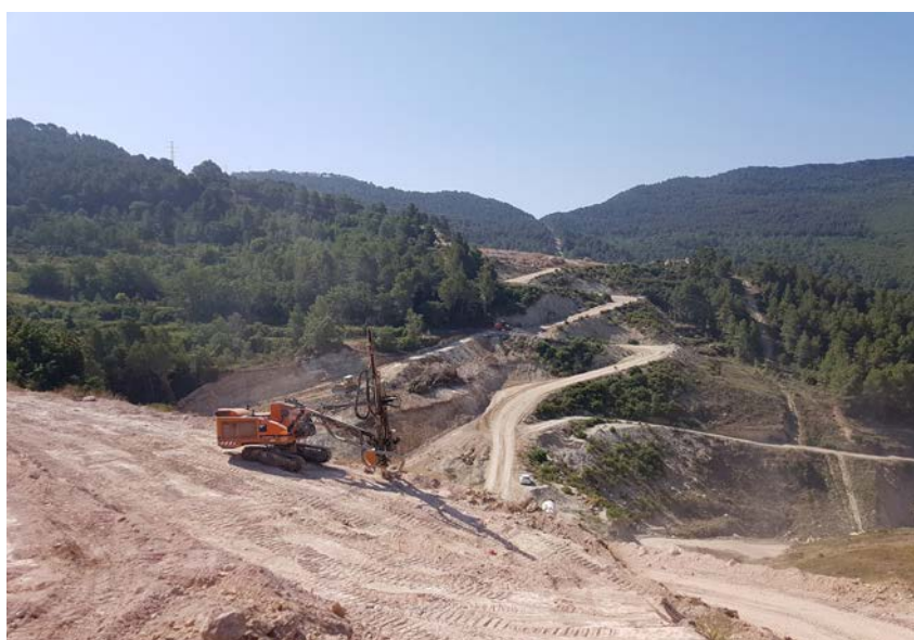
Ejecución del camino de acceso al emboquille Norte del túnel de Lilla.
