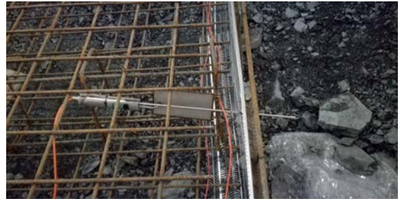
Célula de presión instalada en la contrabóveda de sostenimiento en tramo de pizarras.
