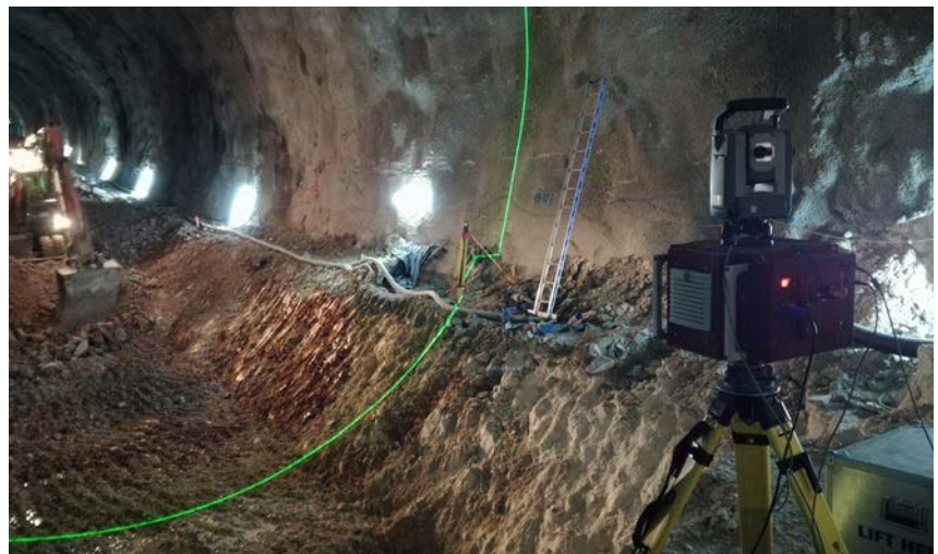
Reperfilado de la sección con la ayuda del equipo de guiado láser.
