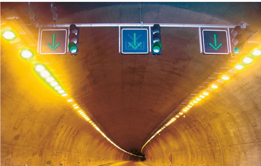
En esta página imágenes de medidas de seguridad en túneles de carretera.
