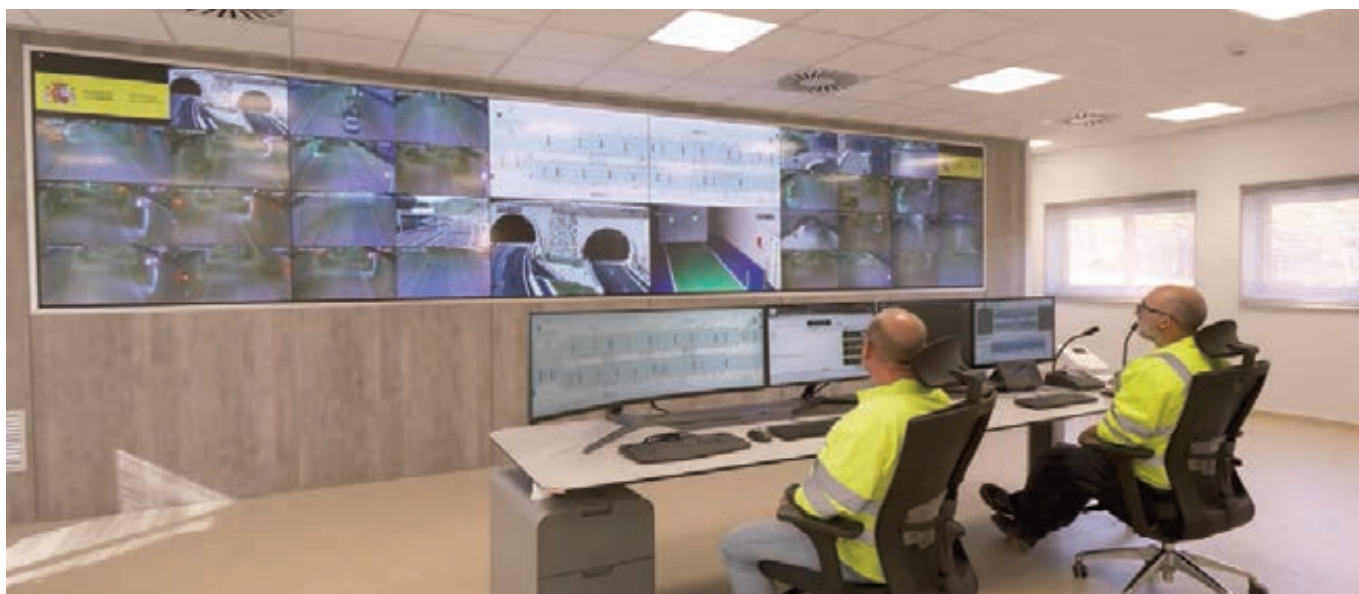
► Página opuesta, interior del túnel de Vallirana. Arriba, videowall del centro de control del túnel.
