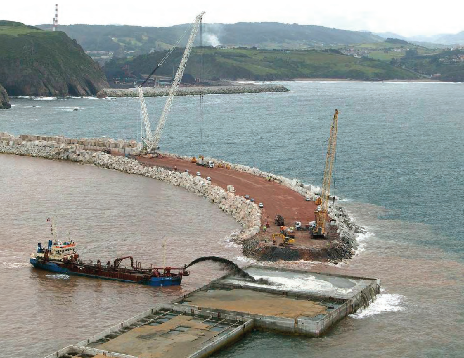
► Puerto de El Musel. Tramo de transición y cambio de alineación entre dique Tones en talud y dique Norte.
