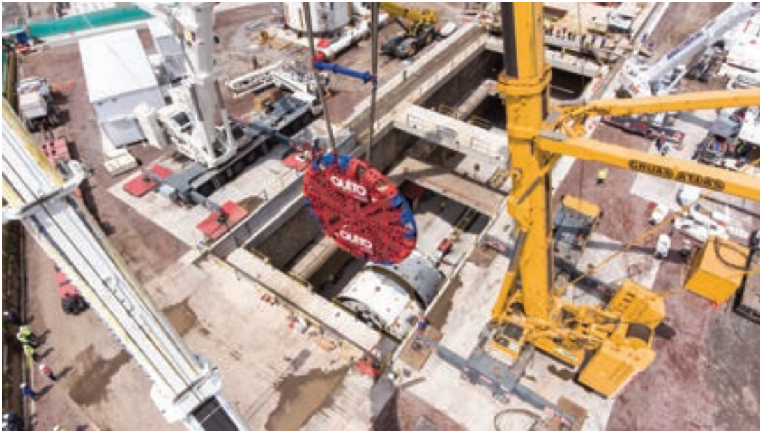
► Traslado de la hoja de corte de la tuneladora La Guaragua, en Quito.
