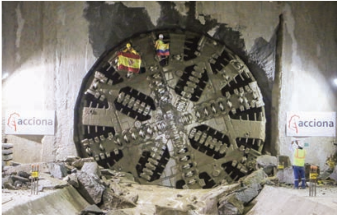
► Cale de una de las tres tuneladoras empleadas para la construcción del túnel del metro de Quito.
