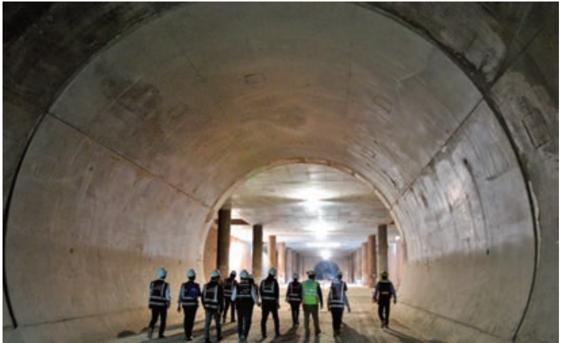
► Túnel revestido y estación en el metro de Lima.
