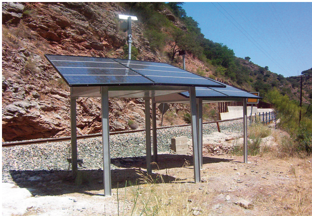
► Paneles solares en vía
