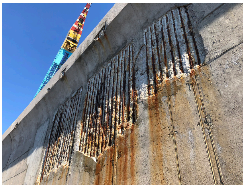
Corrosión de las armaduras del espaldón.
