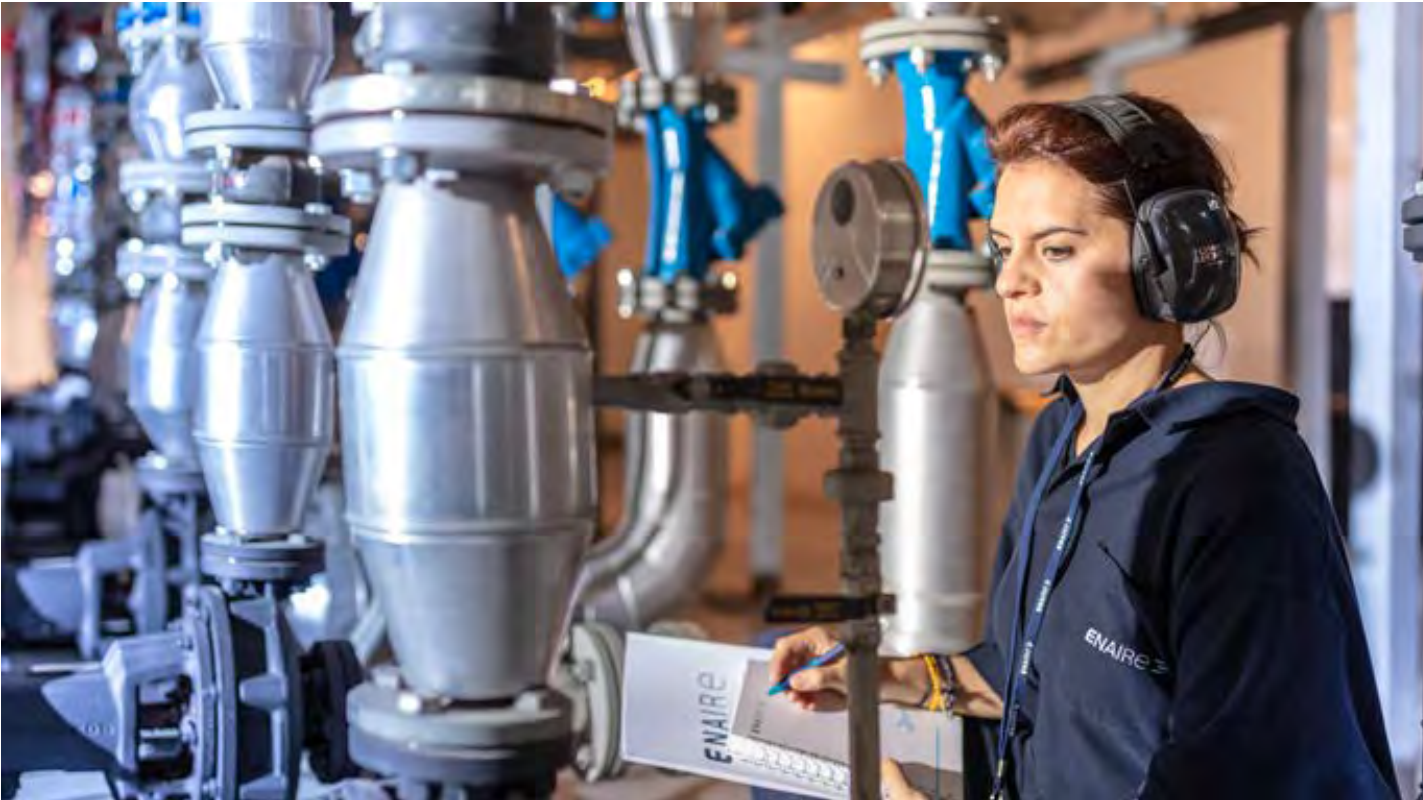
Personal de mantenimiento en Centro de Control de Área Terminal de ENAIRES en València.
