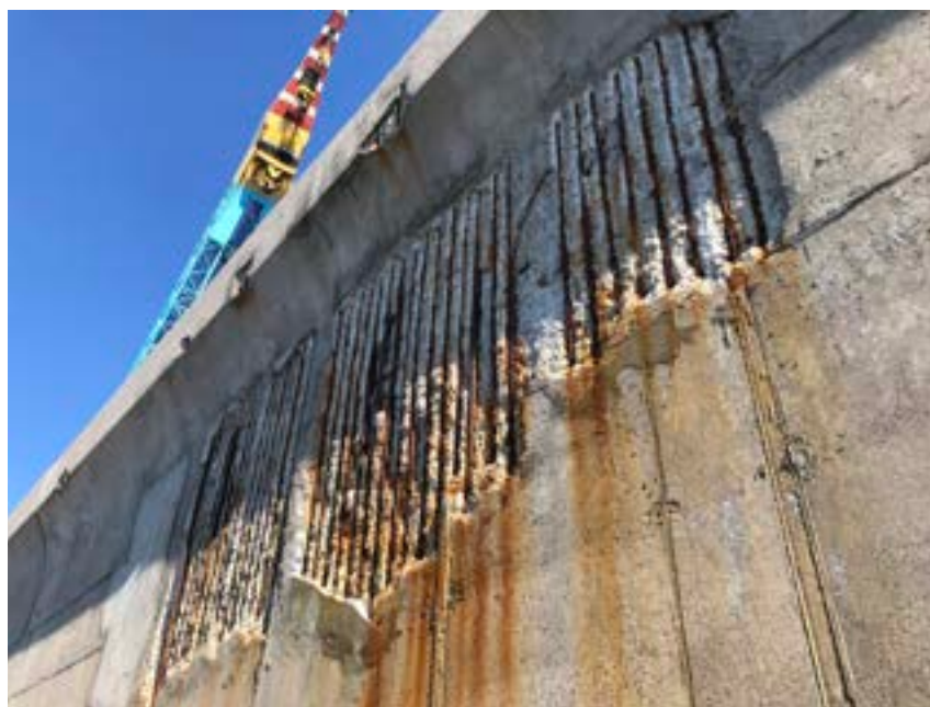
Corrosión de las armaduras del espaldón.
