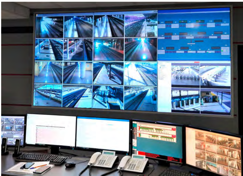
Monitores del centro de control de un núcleo de Cercanías de Renfe.
