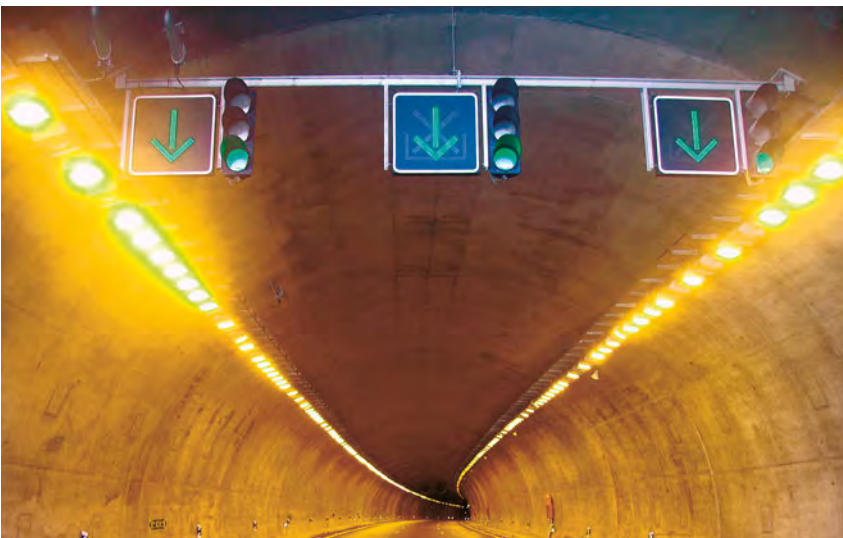
En esta página imágenes de medidas de seguridad en túneles de carretera.
