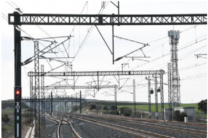
Instalaciones de telecomunicaciones en Valdemoro.
