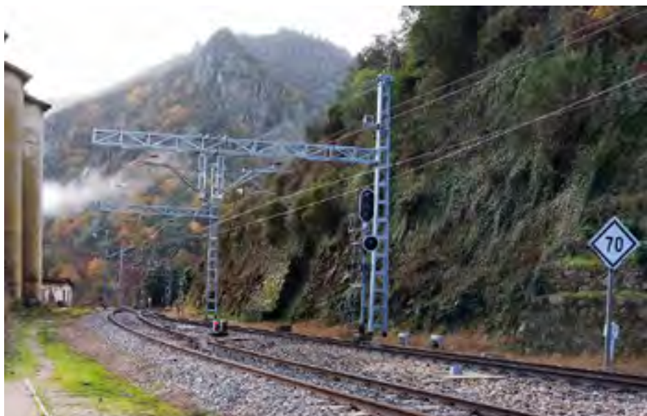
Instalaciones Seguridad (Ourense-Monforte).
