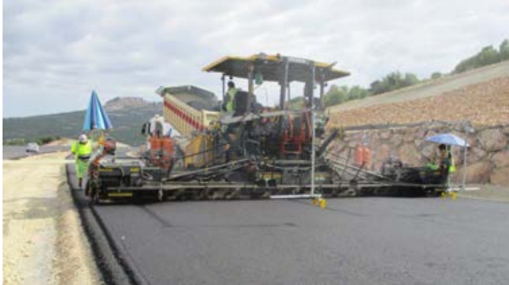
Extendido de la capa intermedia de firme mediante polvo de caucho procedente de neumáticos fuera de uso.
