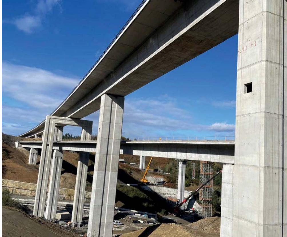
Los viaductos de Zabaleta y Zabaleta Sur materializan el cruce de dos ejes del nudo.
