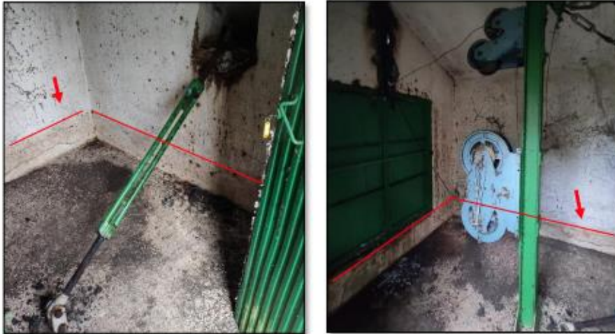
Ilustración 11: Interior de la caseta de la instalación auxiliar aérea de Villamarciel
