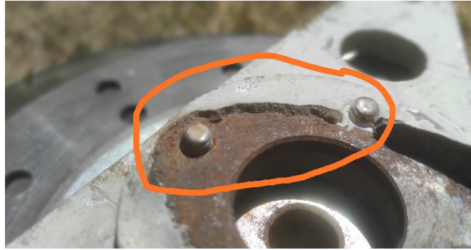
Figura 7. Zona oxidada en la rueda derecha
