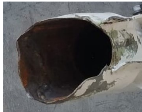
Fotografía 9. Corrosión en fragmento 3
