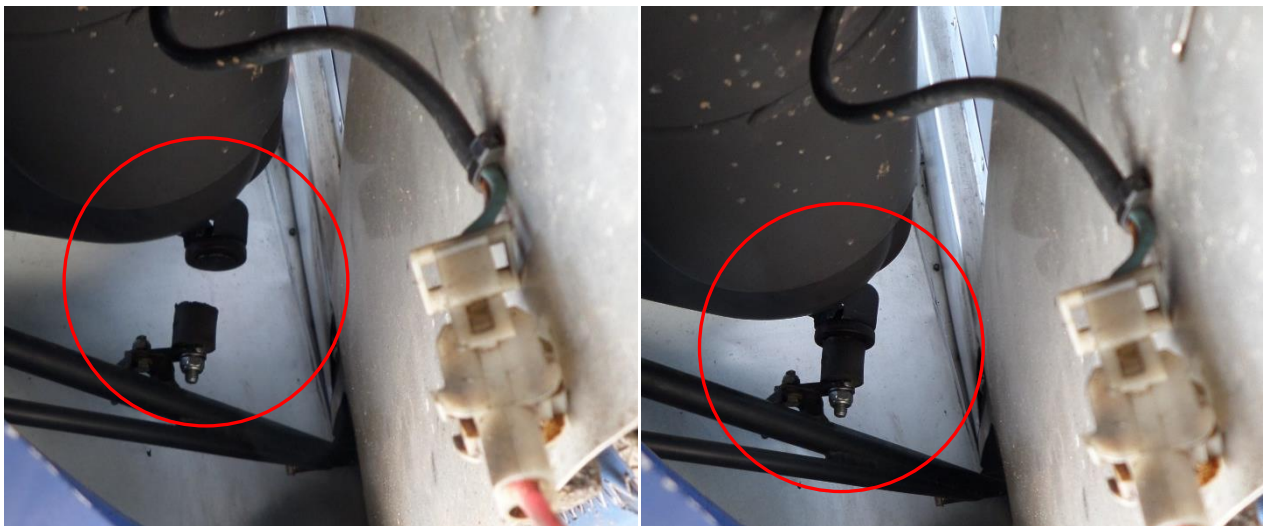
Figs. 6 y 7: Amortiguador de goma ( rubber damper ) del sistema de escape del motor que se ha roto.
