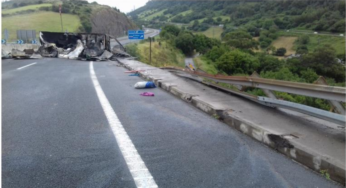
Rotura de barrera metálica y Pretil, tras tercer y último impacto, en margen derecho del puente.
