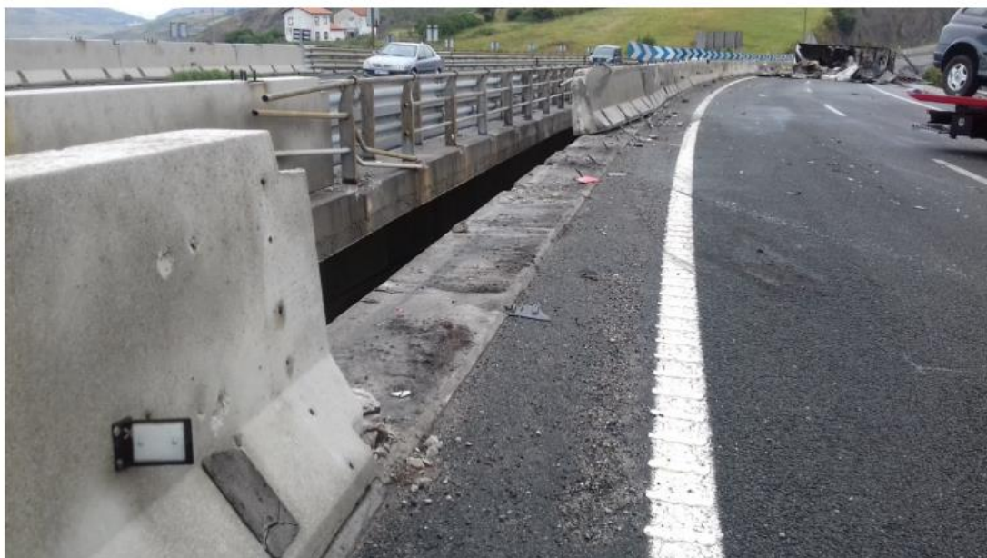
Rotura de New Jersey , tras segundo impacto, en margen izquierdo del puente.
