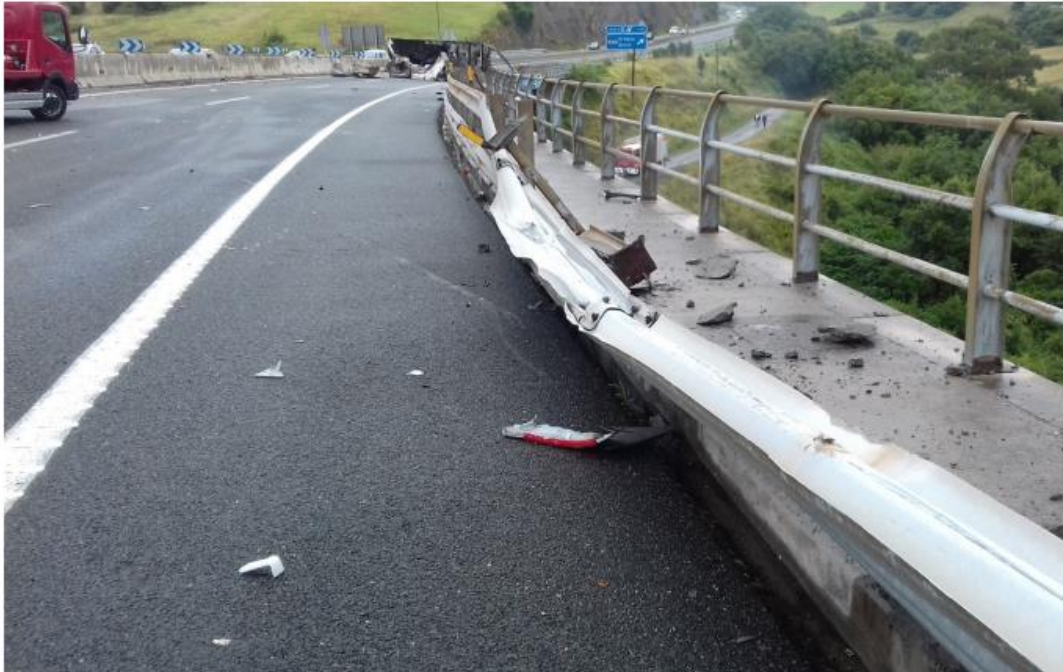
Rotura de barrera metálica tras el primer impacto en margen derecho del puente.
