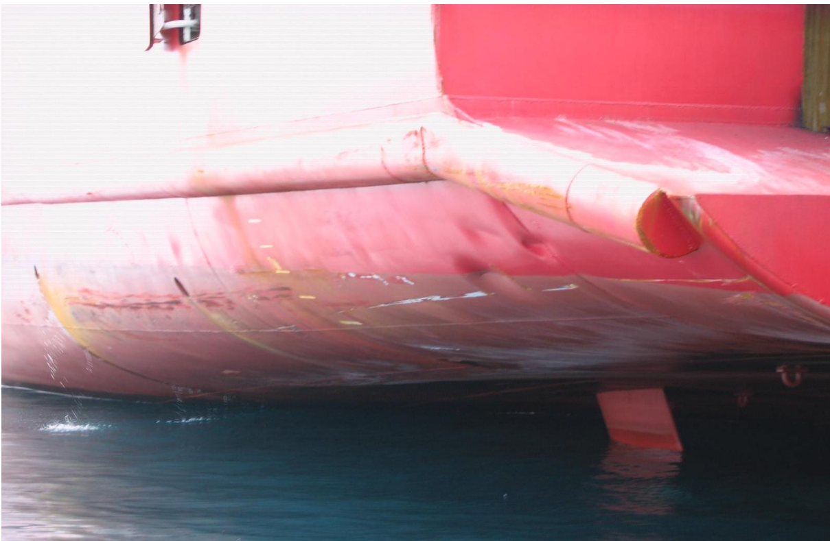
Foto 12 y 13: Costado de babor del buque “ Super Fast Galicia ” dónde se aprecian rozaduras
