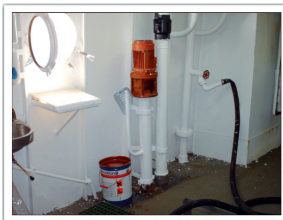
Figura 5. Bomba de achique
