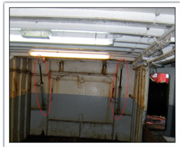
Figura 25. Elementos de sujeción de la compuerta de acceso al parque de pesca desde la cubierta superior
