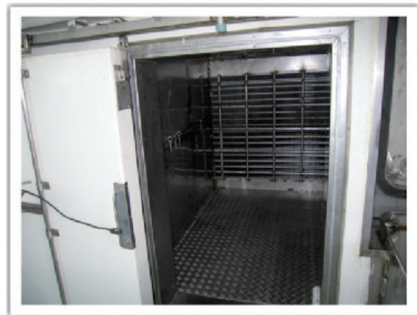
Figura 11. Túnel de congelado
