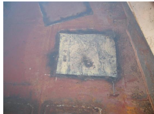
Corte entre las cuadernas 21 y 22, donde se observa el lastre.
