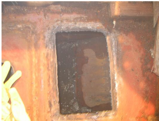
Corte entre las cuadernas 20 y 21, donde se observa que esta vacío.
