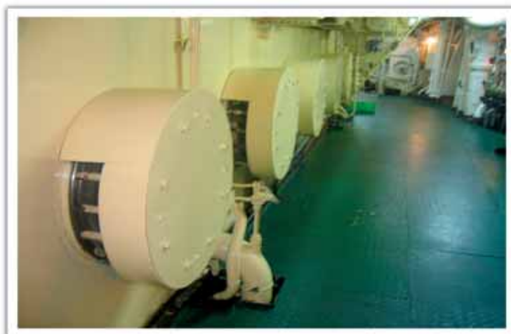
Figura 30. Vista de las válvulas de seguridad del motor principal
