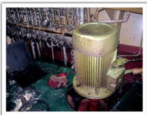
Figura 5. Aspecto de una zona próxima a la explosión
