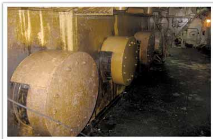
Figura 32. Vista de la zona de válvulas de seguridad después de la explosión
