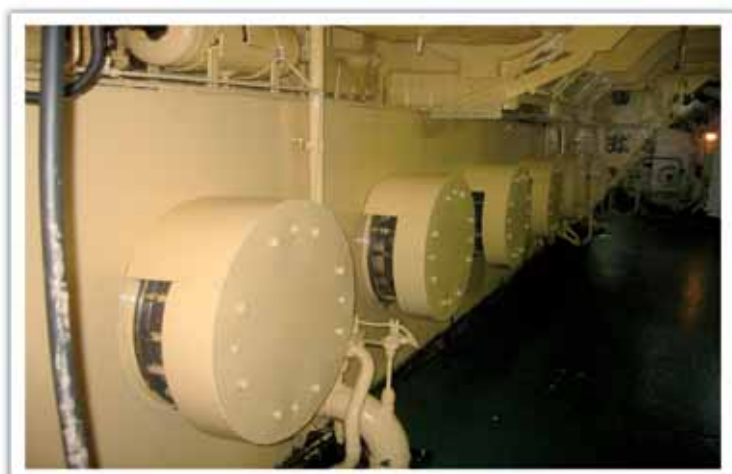
Figura 31. Vista de las válvulas de seguridad del motor principal
