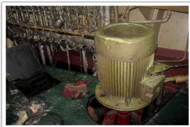
Figura 34. Vista parcial de la sala de máquinas después del accidente
