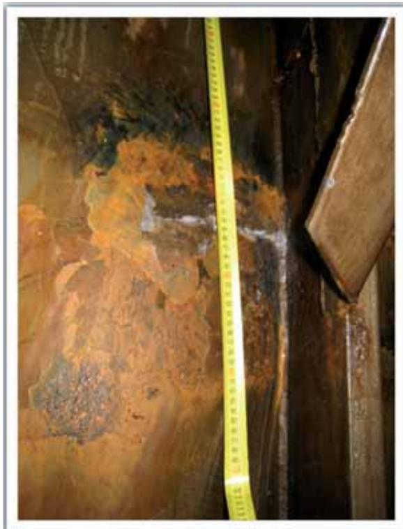
Figura 18. Abolladura junto a la grieta en la zona alta del pique de popa
