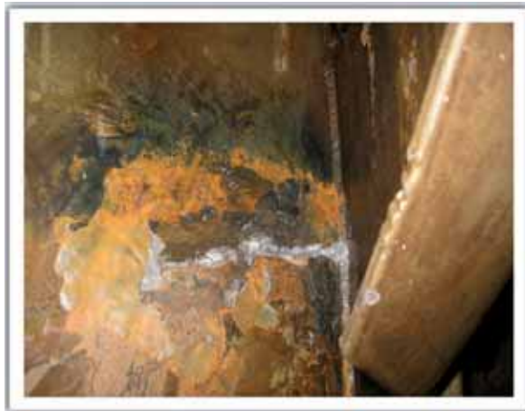
Figura 7. Grieta en el pique de popa
