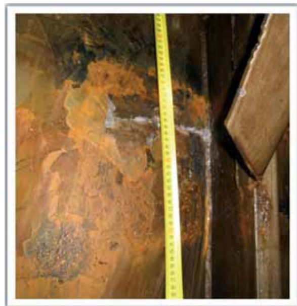
Figura 30. Abolladura en la zona de la grieta del pique de popa
