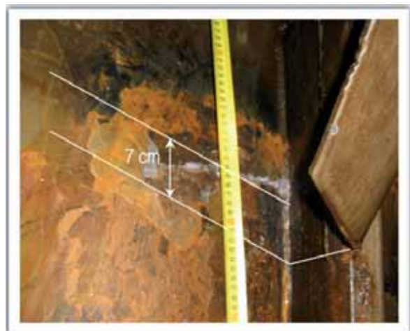
Figura 11. Distancia de la grieta al extremo inferior de la cartela
