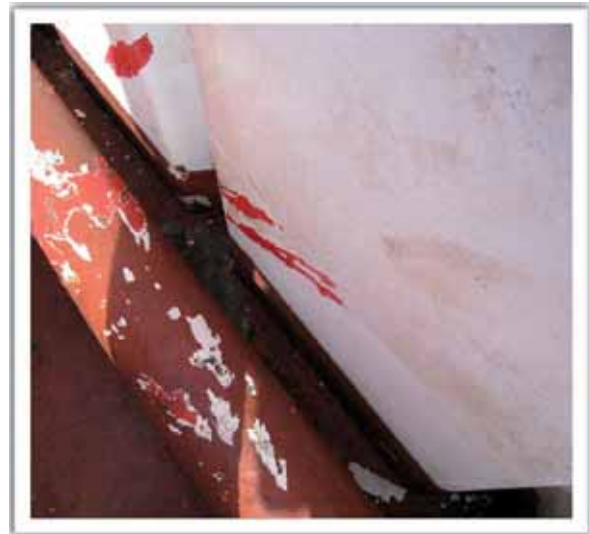
Figura 14. Grietas en la superestructura
